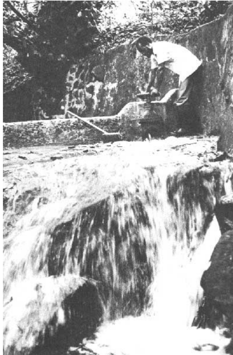
J. Vizcarra Brenner/OPS - À Sainte-Lucie, un agent du service des eaux détourne les eaux de surface vers un réservoir de désinfection. La préparation
